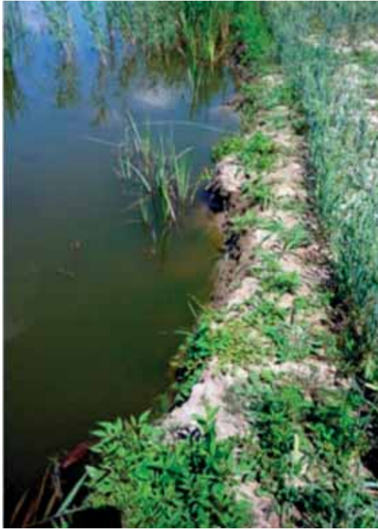
Fig. 9 - Particolare di un argine interessato dall'attività di scavo dei crostacei e già parzialmente crollato.
