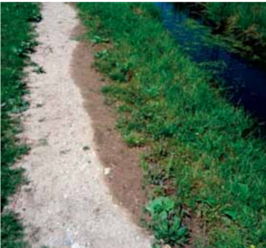
Fig. 10 - Evidente infiltrazione spondale interessante un tratto di circa 20 metri.
